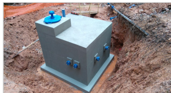
Collecteur général de raccordement des 4 sources (extérieur)
